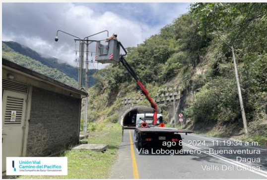
Mantenimiento cámara PTZ
