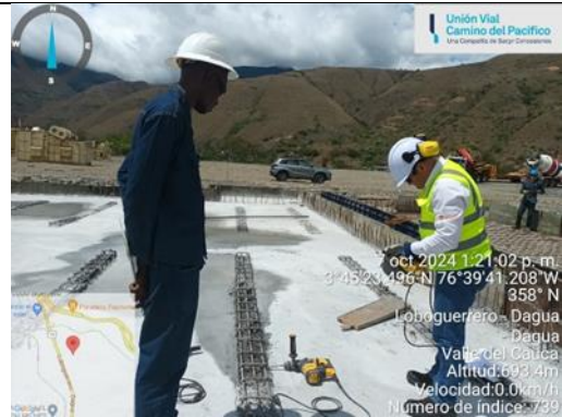
Inspección de herramienta manual
